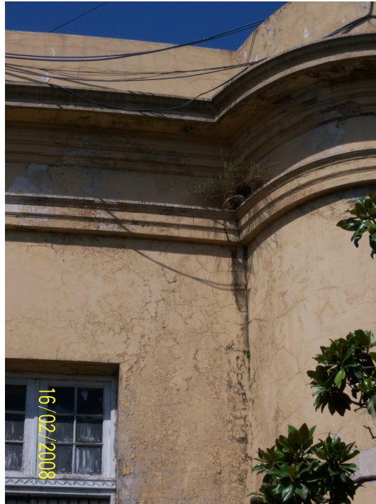
Fig.22- Deterioro por humedad.
