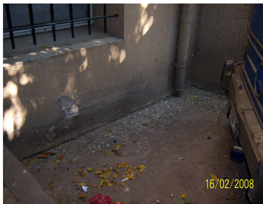
Fig.21- Superficie receptora de agua de lluvia.
